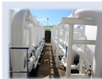
Unité de traitement de Bouyouni (filtres à sable)
