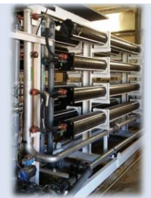
Unité de traitement de Pamandzi (membranes d'osmose inverse)
