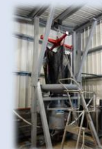
Système d'injection de charbon actif en poudre
