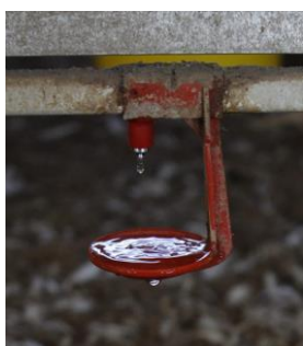
Un abreuvoir qui fuit peut dégrader l'état de la litière
