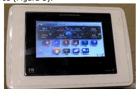
Figura 3: Panel de control de temperatura, humedad y gases de la nave
