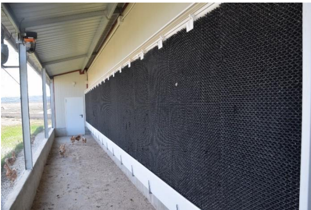
Figura 2: Paneles de enfriamiento vistos desde la veranda cubierta, fuera de la nave. Fuente: ANIVET
