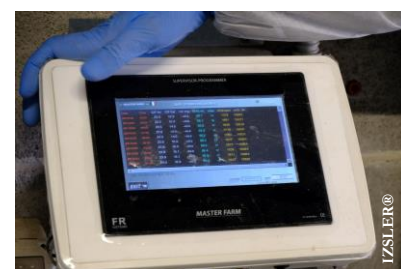
Figura 4. Panel de control de parámetros de calidad del aire y ventilación
