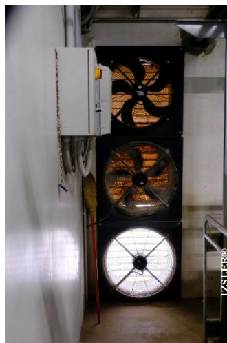
Figura 3. Sistema de ventilación forzada
