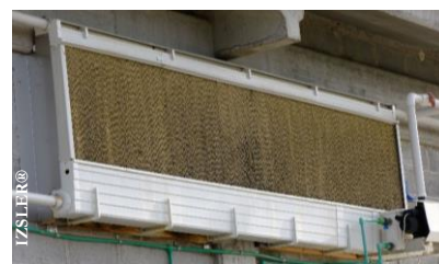
Figura 2. Sistema de refrigeración
